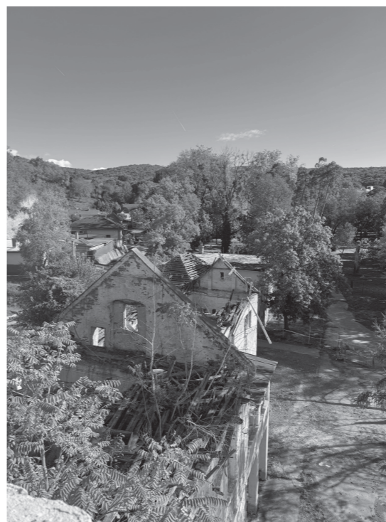
1 objekt kaštiela v schátralom stave bez strechy a prepadnutými stropmi
