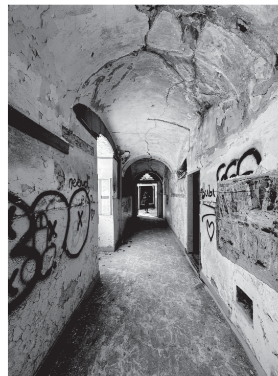
2 praskajúci interiér s opadanými omietkami poznačenými vandalizmom
